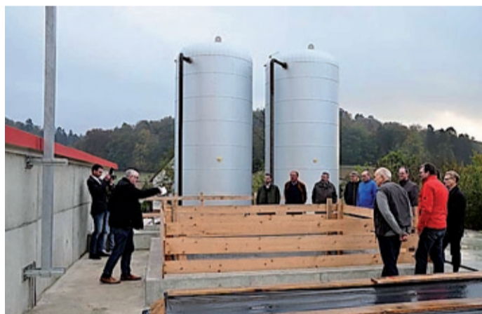
Dieter Bartelmeß (links) erläutert auf dem Dach des Holzhackschnitzel-Bunkers, wie der natürliche Brennstoff vom Lkw in den Bunker geschüttet wird. Im Hintergrund stehen die beiden Wärmepufferspeicher, die ihre Wärme immer dann abgeben, wenn sie gebraucht wird.
