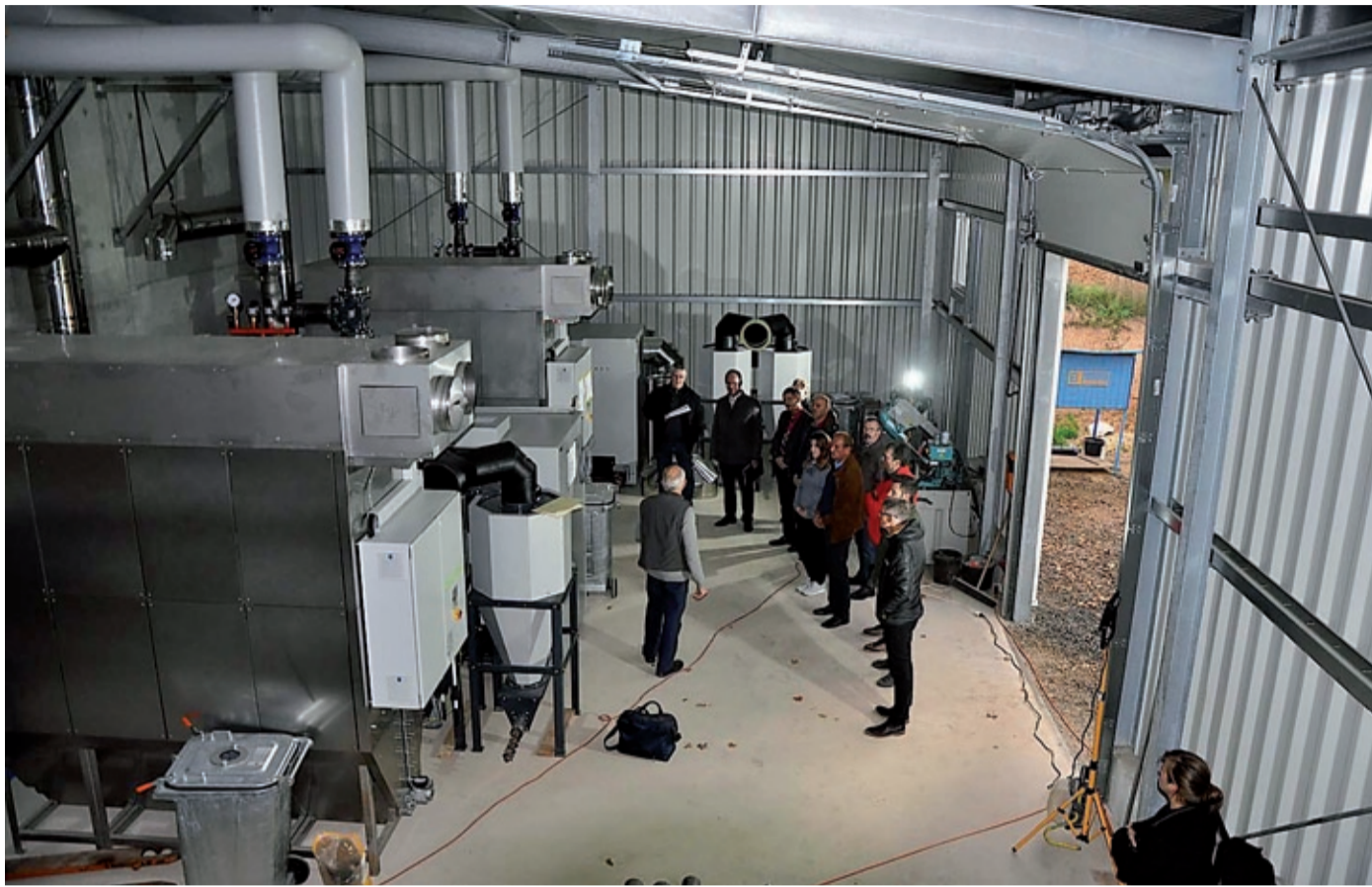
In der Heizzentrale der Genossenschaft Nahwärme Rauschenberg stehen derzeit zwei 800-kW-Heizkessel, die noch nicht betriebsbereit sind. Wenn für den 3. Bauabschnitt das Neubaugebiet angeschlossen wird, kommt ein Heizkessel dazu. Fotos: Matthias Mayer
